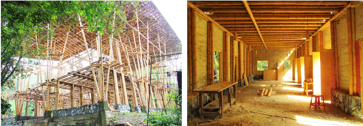
Figure 9. Construction Fundación Escuela Para La Vida, Cali, Colombie - Structure de poteaux et putres. Source: Greta Tresserra (Archdaily)
